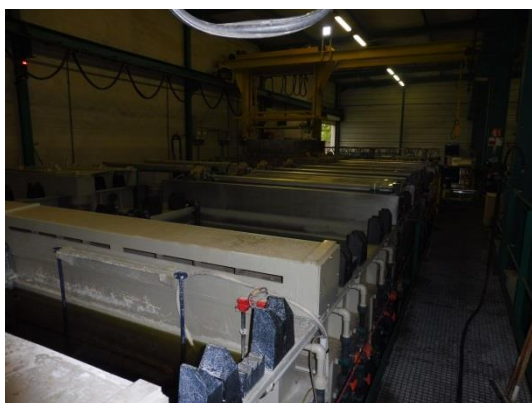
Ligne de nickelage sur le site de LILLE
